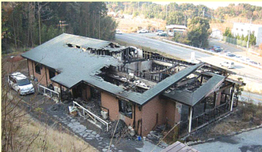
◀ 火災発生後の建物の外観 (総務省消防庁ホームページより)
